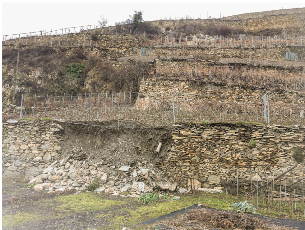
Eingestürzte Stützmauern im Weinberg in Terrassenlage in Sion VS.
