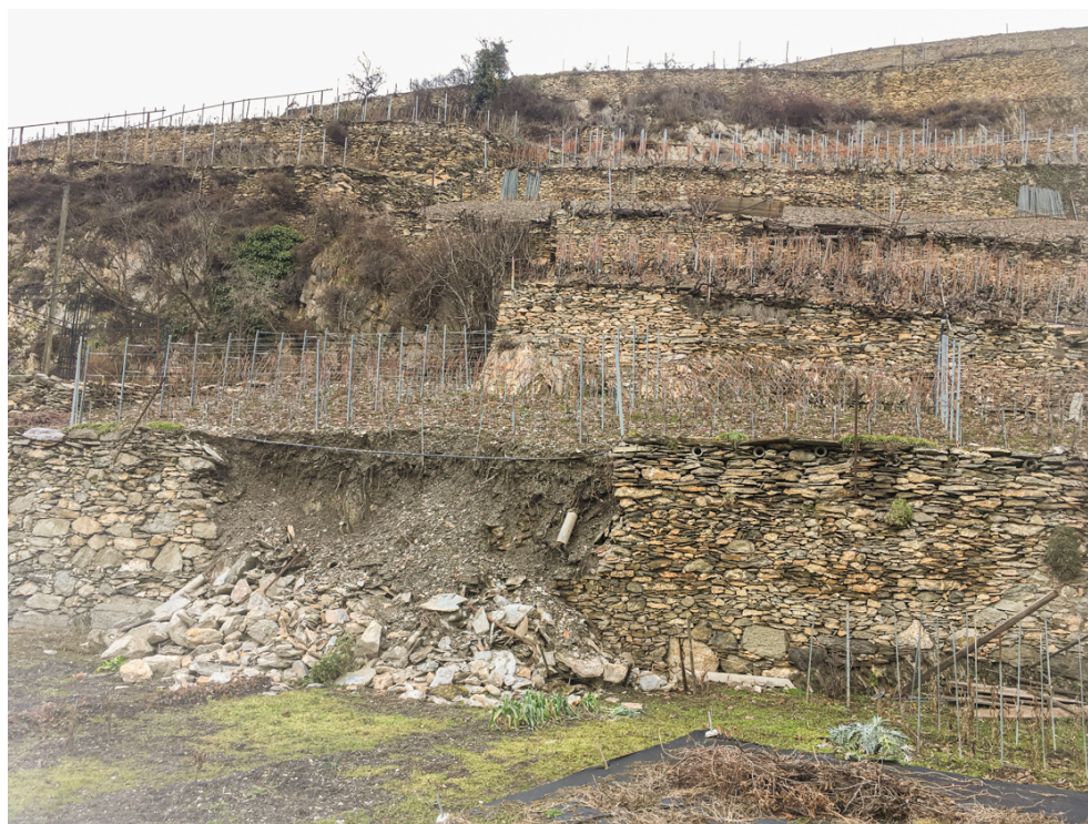
Murs en pierres sèches de soutènement de terrasses viticoles effondrés à Sion VS.
